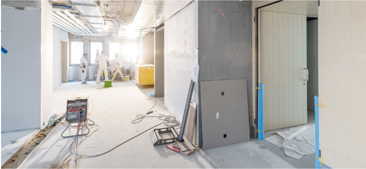
Der Innenausbau läuft auf Hochtouren, damit die Infrastruktur im neuen Gebäudetrakt rechtzeitig zur Verfügung steht.
